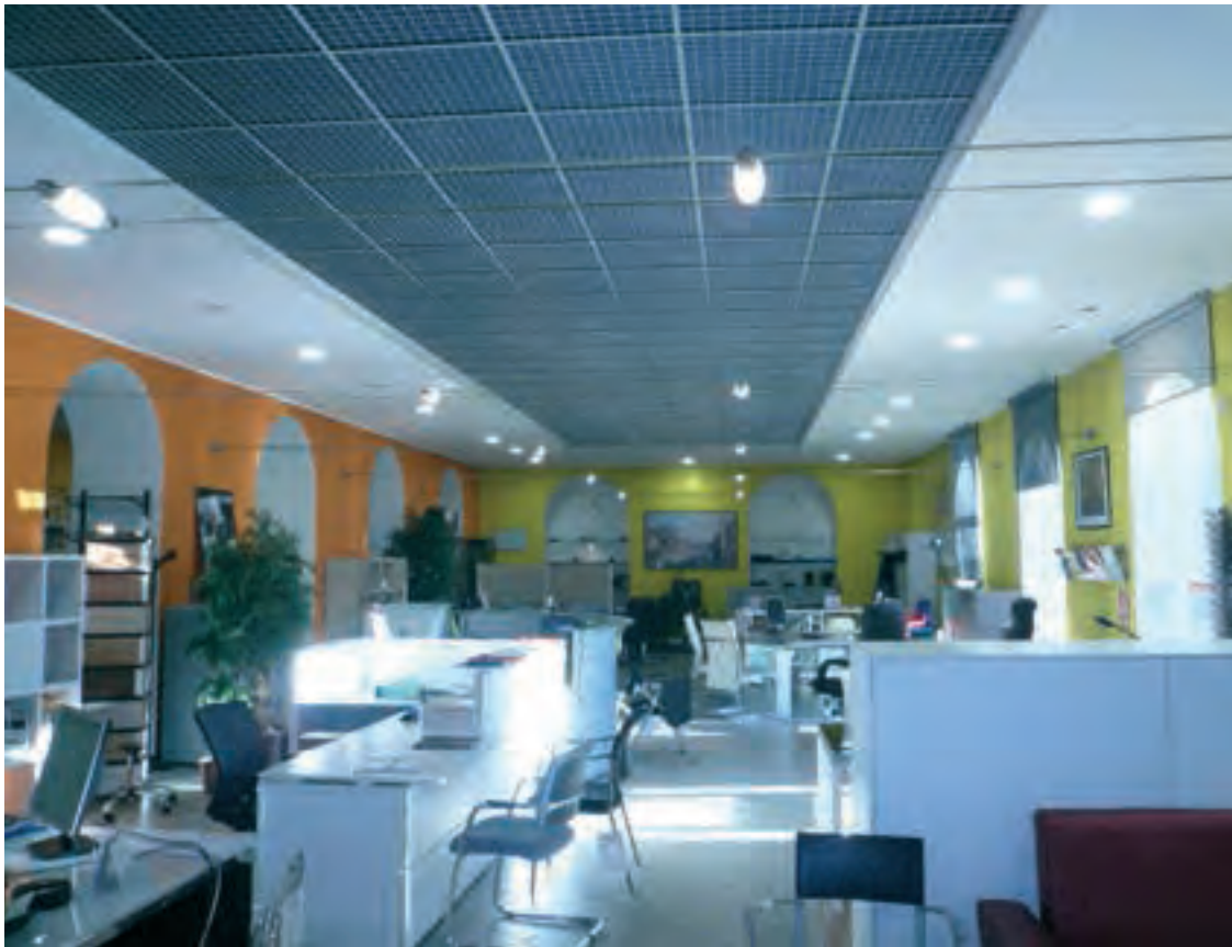
Controsoffitto "a vasca" in cartongesso con posa al suo interno di controsoffitto metallico.
