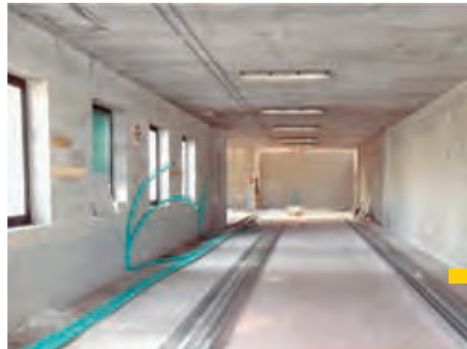
Prima del nostro intervento
