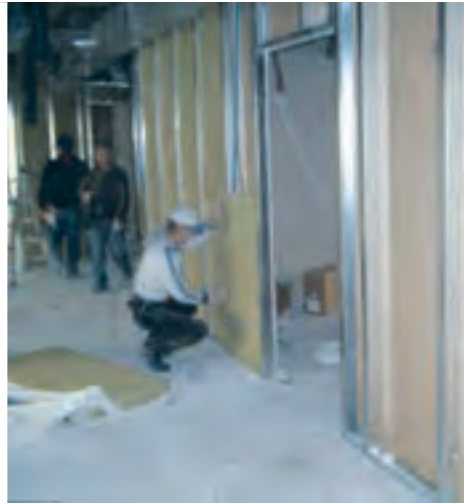
Chiusura con lastre in cartongesso, su entrambi i lati della struttura ed eventuale inserimento di lana di roccia isolante.
